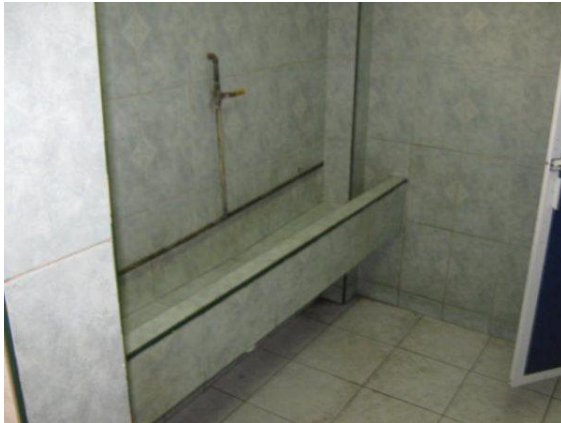
IMAGEN 6 FOTO E.V.C. EN LA IMAGEN SE MUESTRA LA ZONA DEL MINGITORIO DE LOS SANITARIOS DE AYUNTAMIENTO
