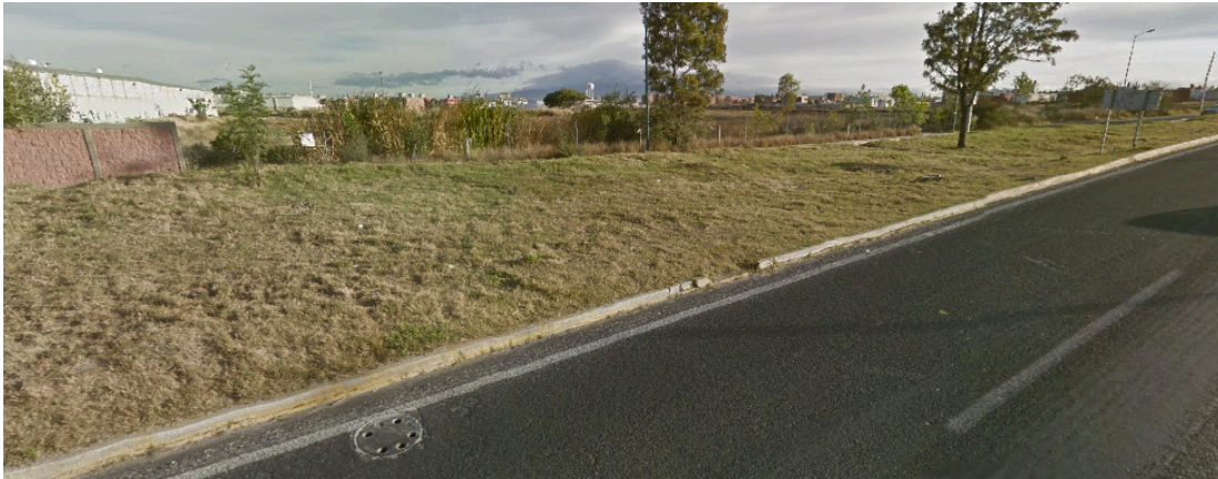
Fotos 54 – 56: Condiciones de banquetas y guarniciones.
