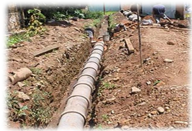
Red de drenaje
