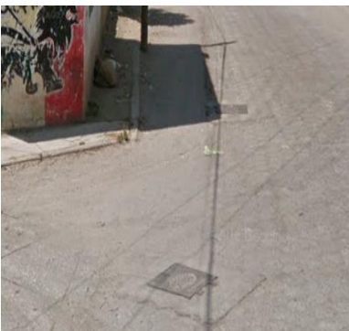
Imagen 137: Fotografía de registro de agua potable.
