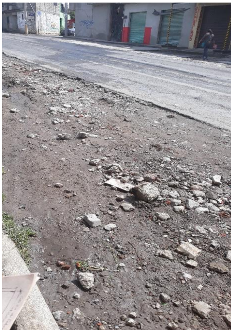
Imagen 135: Av. López mateos norte, se muestra vialidad principal y terracería en mal estado.
