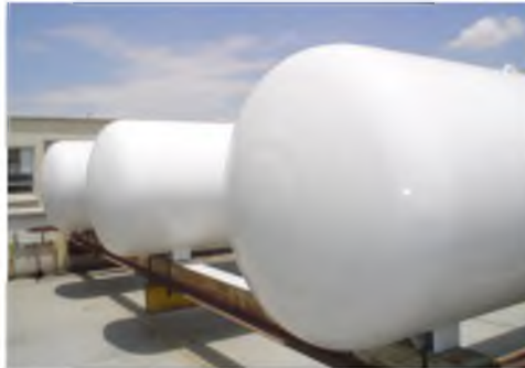
FOTO: TANQUES ESTACIONARIOS DE GAS
