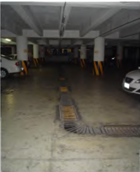
FOTO: REJILLAS DE DESAGUE
