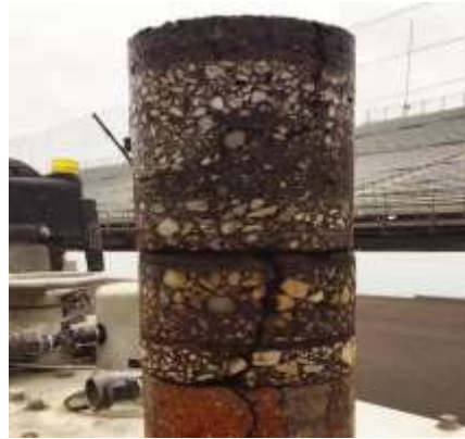
Figura 44.- Sobrecarpetas asfálticas (extracción de núcleo)
