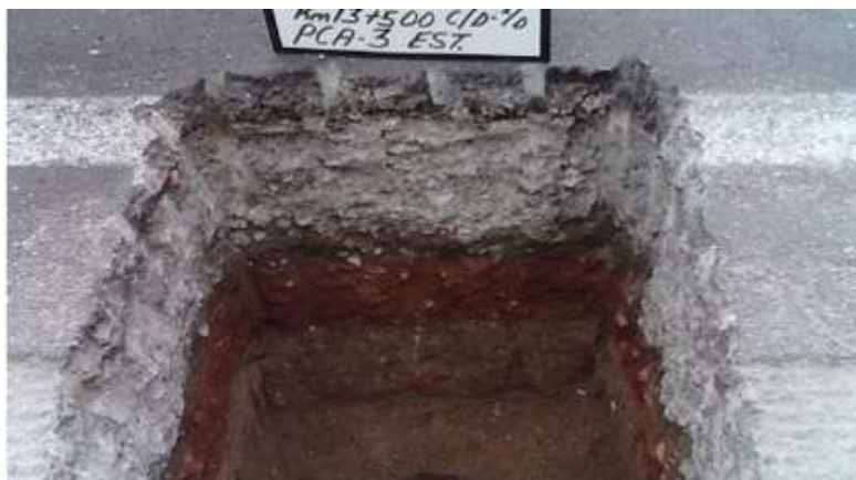
Figura 39.- Espesores de capas de pavimento obtenidos de calas o sondeos (corte transversal).
