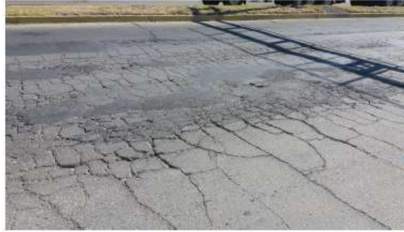
Figura 6.- Agrietamiento por fatiga (BUAP, 2018)
