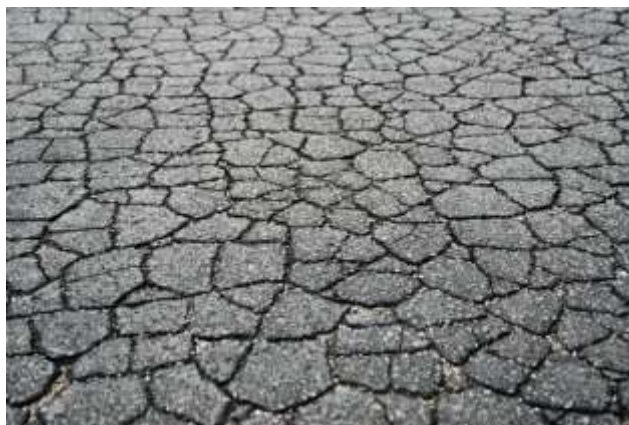
Figura 42.- Discontinuidad longitudinal en pavimentos altamente agrietados (piel de cocodrilo).
