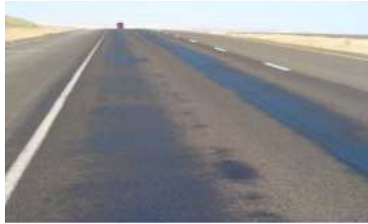
Figura 4.- Exudación de capas asfálticas. (Fuente)
