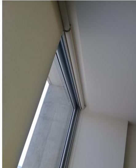
Figura 63. Cajillo para persiana nivel 3, Edificio Artema. Puebla, México (2018). Elaboración propia.
