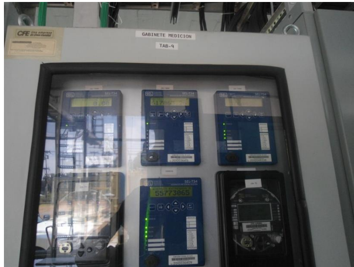
Figura 2.12 Gabinete de relevadores en subestación.
