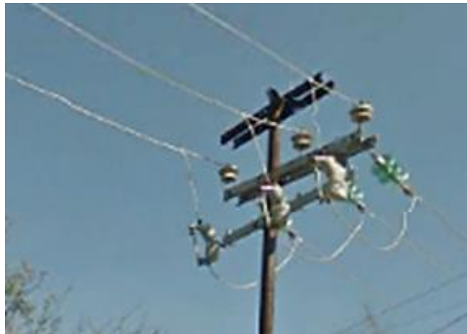
Figura 2.14 Cortacircuitos fusibles en líneas de media tensión
