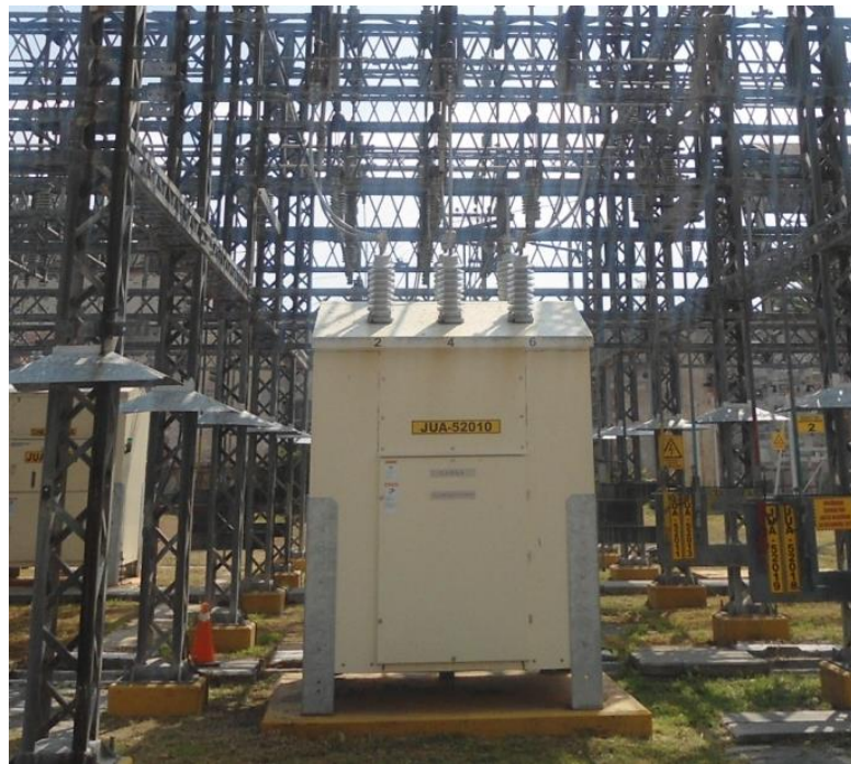
Figura 2.11 Interruptor de subestación en el bus secundario de 23 kV.
