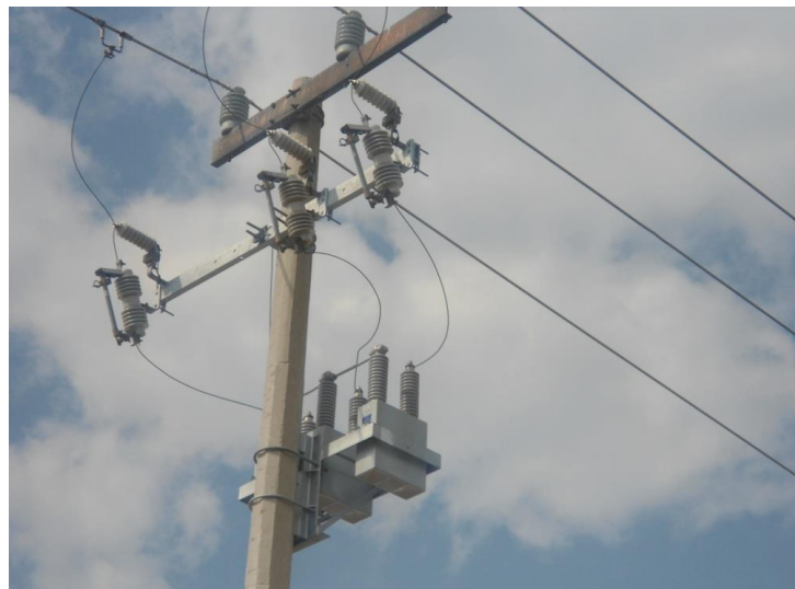
Figura 2.15 Bancos de capacitores en líneas de media tensión.
