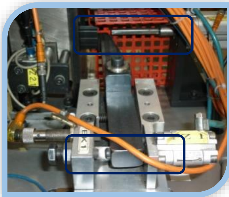
Ilustración 6 Primera Estación (Sistema de Activación de la Serie de Cuchillas)
