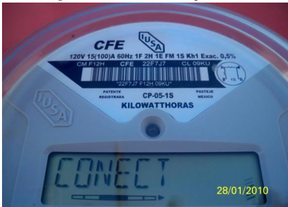
Fig. 3.17 Estado del Relevador
