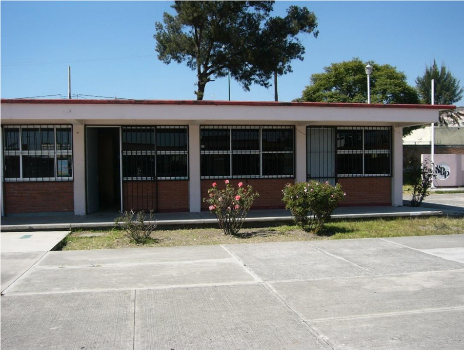
Imagen 62. Pasillo con 80 cm de ancho, no existe barandal área de dirección y aulas primaria. Centro de Atención Múltiple Tepeaca. Ubicado en calle Francisco I. Madero (Foto septiembre 2010)
