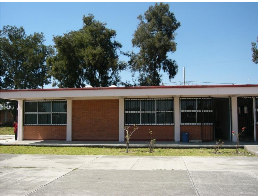
Imagen 63. Pasillo con 80 cm de ancho, no existe barandal área de dirección y aulas primaria. Centro de Atención Múltiple Tepeaca. Ubicado en calle Francisco I. Madero (Foto septiembre 2010).
