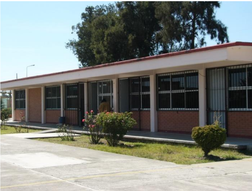
Imagen 61. Pasillo con 80 cm de ancho, no existe barandal área de dirección y aulas primaria. Centro de Atención Múltiple Tepeaca. Ubicado en calle Francisco I. Madero (Foto septiembre 2010)
