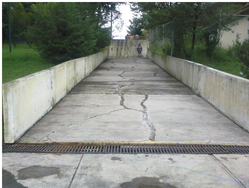
Imagen 29. Acceso al área designada para educación nivel primaria (rampa), CAM Col. San Miguel Cd. Puebla (foto tomada mayo 2010).
