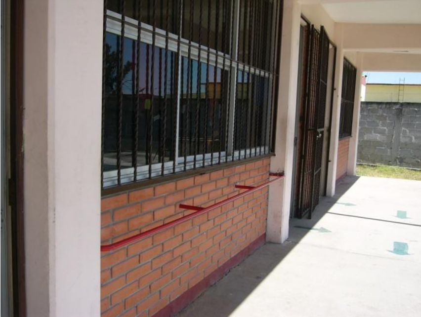
Imagen 58. Pasillo con 80 cm de ancho, existe barandal solo en el muro aula primaria, preescolar y estimulación temprana. Centro de Atención Múltiple Tepeaca. Ubicado en calle Francisco I. Madero entre (Foto septiembre 2010)
