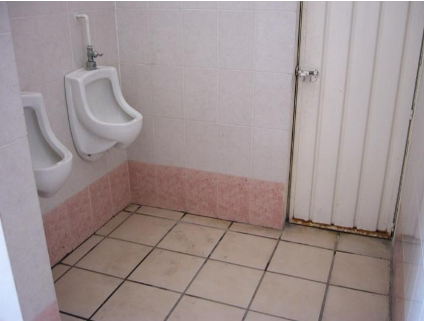
Imagen 67. Sanitarios, área de mingitorios. Centro de Atención Múltiple Tepeaca. Ubicado en calle Francisco I. Madero. (Foto septiembre 2010).
