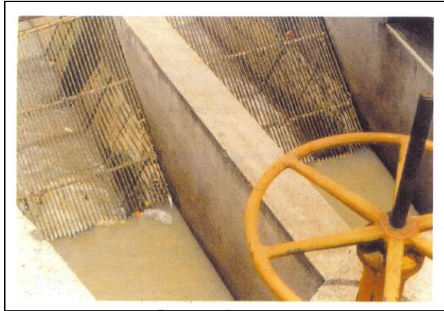
Fig. 3.8.- Rejillas finas para eliminar sólidos gruesos a la planta.
