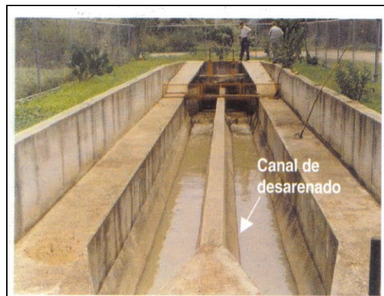
Fig. 3.9.- Canal desarenador para ayudar a sedimentar todas las partículas que logran pasar las rejillas finas.
