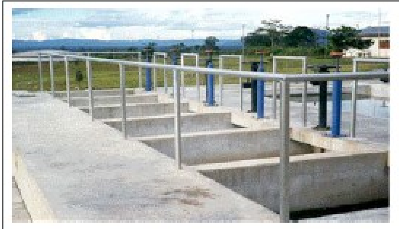
Fig. 3.19.- Batería de filtros de tasa declinante.
