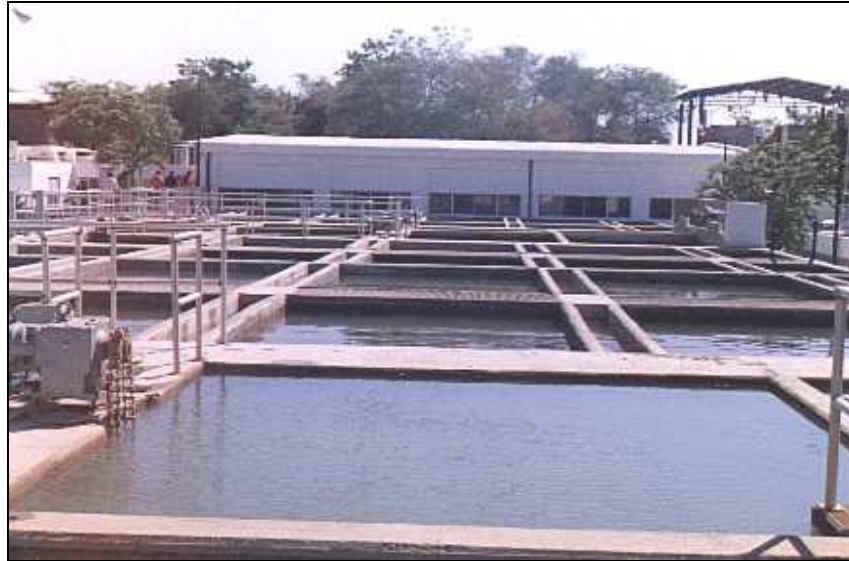
Fig. 3.10.- Sedimentador del proceso de coagulación.
