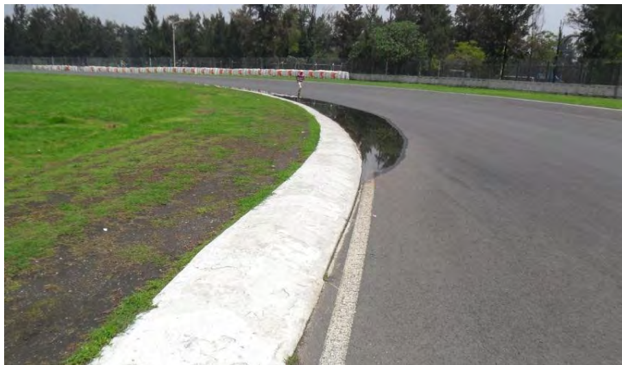
34Circuito Hermanos Rodriguez, problemas de drenaje (2011)
