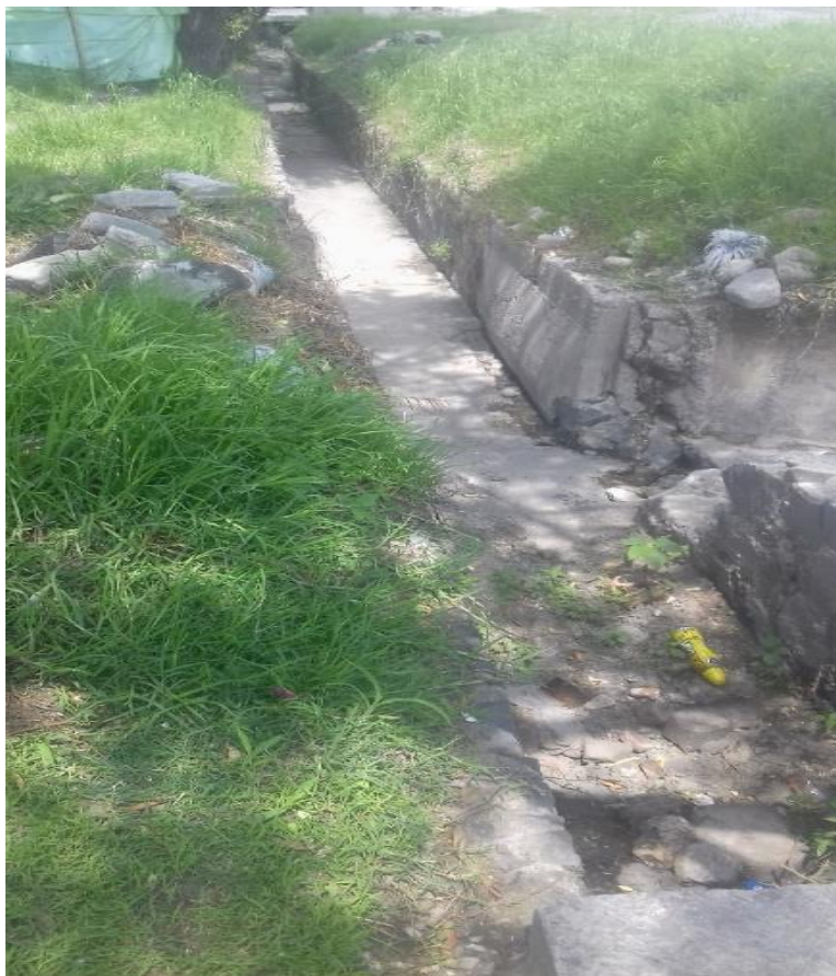
Foto 4: Una de las zanja que se ubica por el kilómetro 8. Autor: Idalia D. Uvera López
