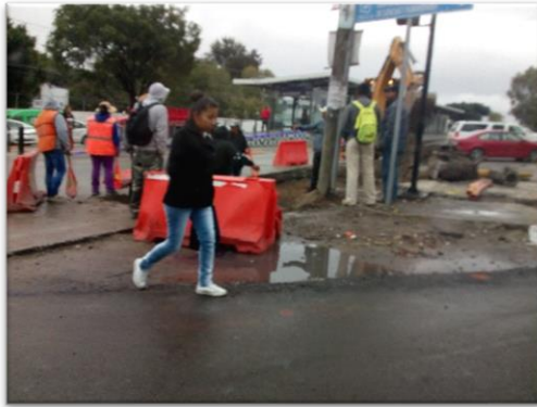
Figura 41 Trabajos inconclusos en el boulevard
