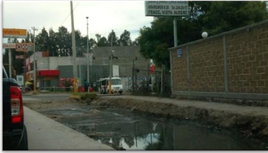
Figura 26 Inundación e inexistencia de aceras
