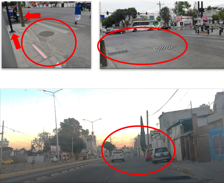
Figura 77 Barreras físicas encontradas en el entorno urbano
