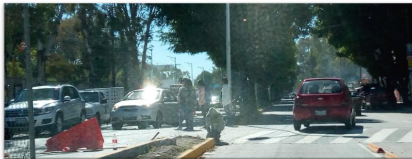
Figura 34 Construcción de cruces inteligentes ignorados por los vehículos
