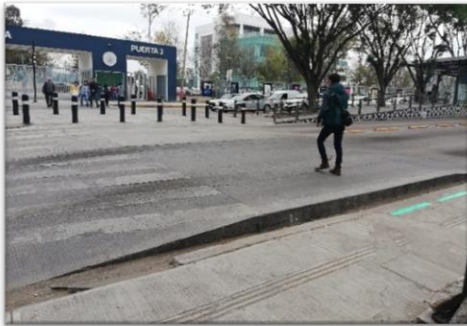
Figura 75 Separación entre banqueta y tope
