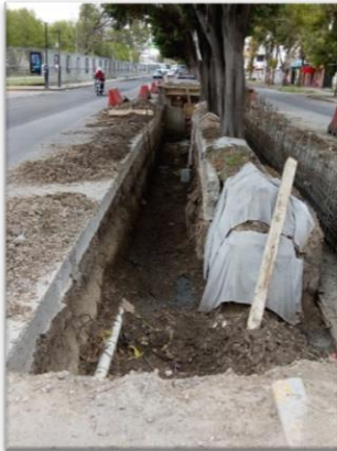
Figura 28 Zanjas sin protección peatonal
