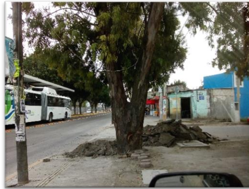
Figura 42 Escombros sobre las aceras
