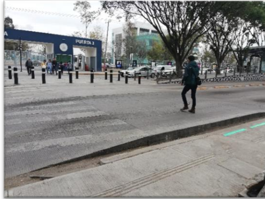
Figura 69 Rampas incompletas en Biblioteca Central
