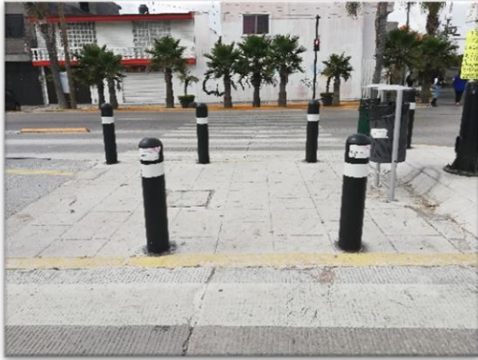
Figura 68 Rampas inaccesible en Arboledas
