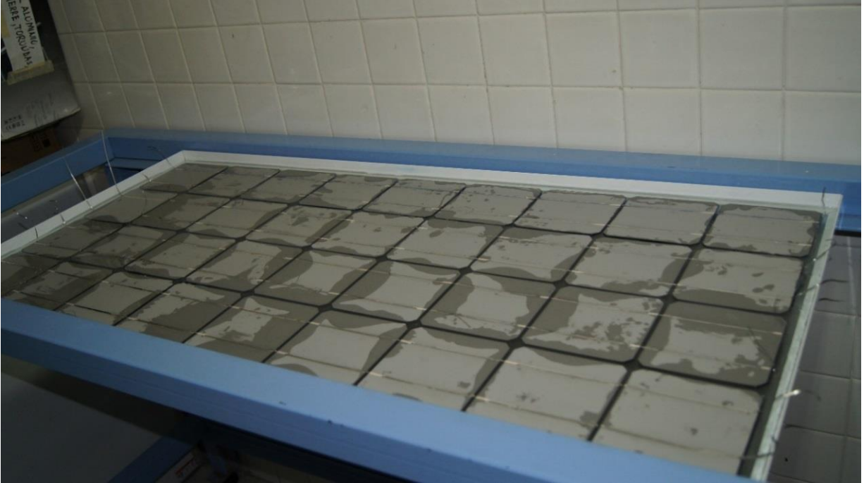
Figura 3. 9 Arreglo de celdas solares unidas al vidrio de la cubierta frontal mediante el material encapsulante.
