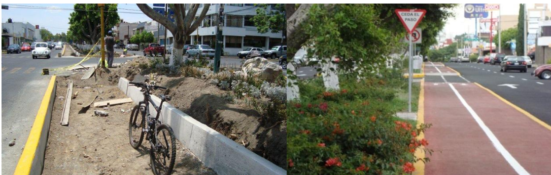
A la izquierda la Ciclovía de la 31 Ote en construcción Cd. de Puebla (Mayo 2009), a la derecha la Ciclovía terminada.
