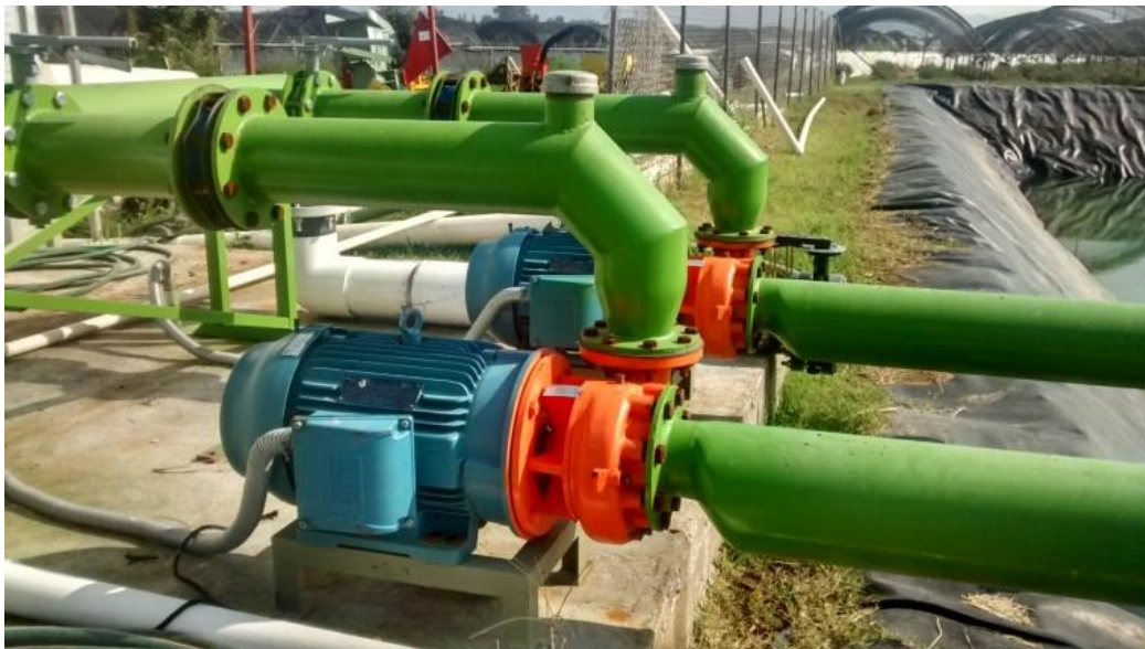
Figura 31.- Bateria de bombas en operación paralela
