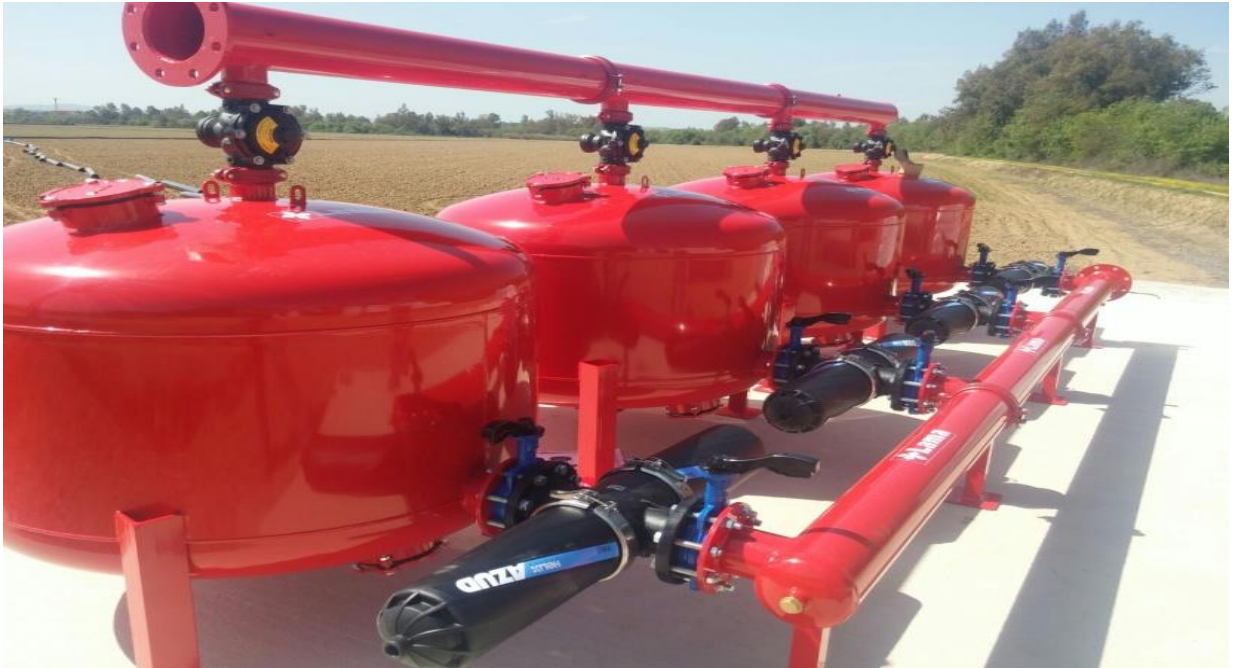
Figura 30.- Bateria de filtración de arena automática
