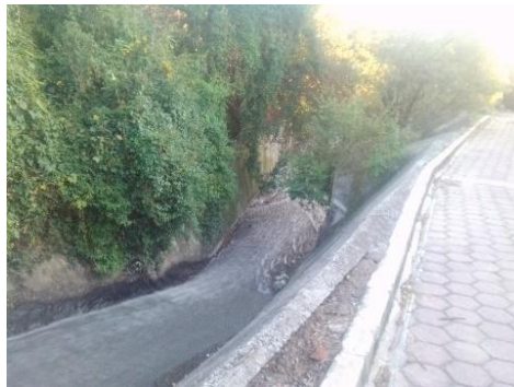
Foto 13: Descarga de agua pluviales Fuente (Mendez 2020)
