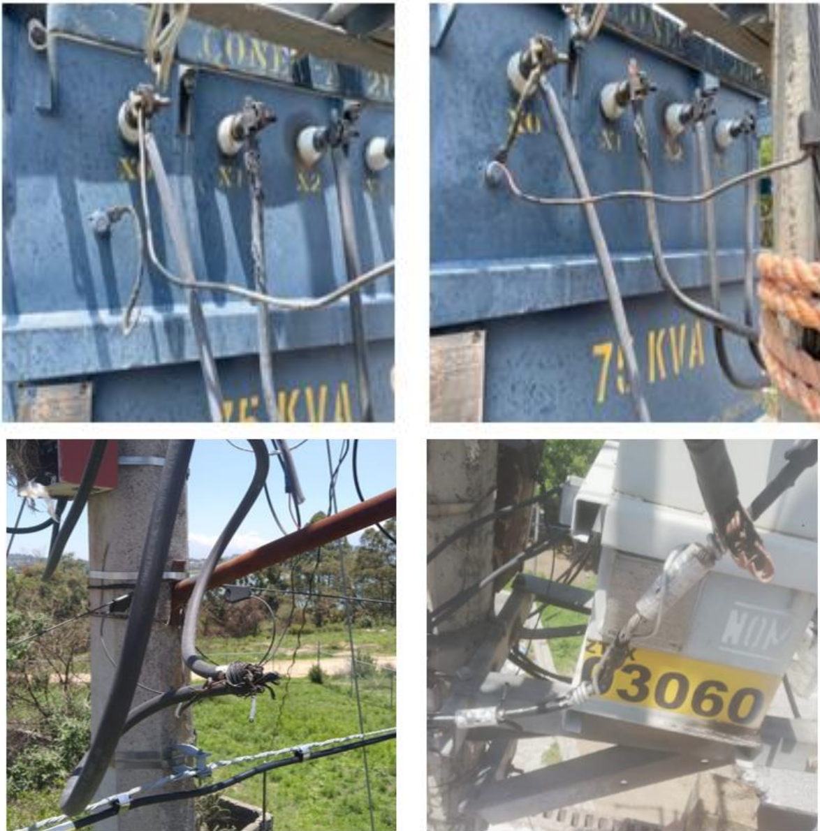
Figura 22. Mantenimiento a sector por causa de salida falso contacto
