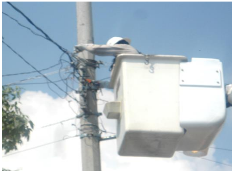
Figura 3. Deficiencias de voltaje
