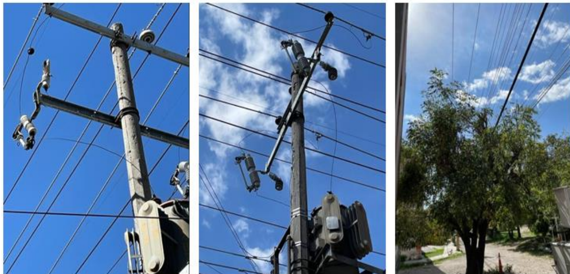
Figura 19. Mantenimiento a sector por causa de descarga atmosférica en apartarrayos y árboles o ramas
