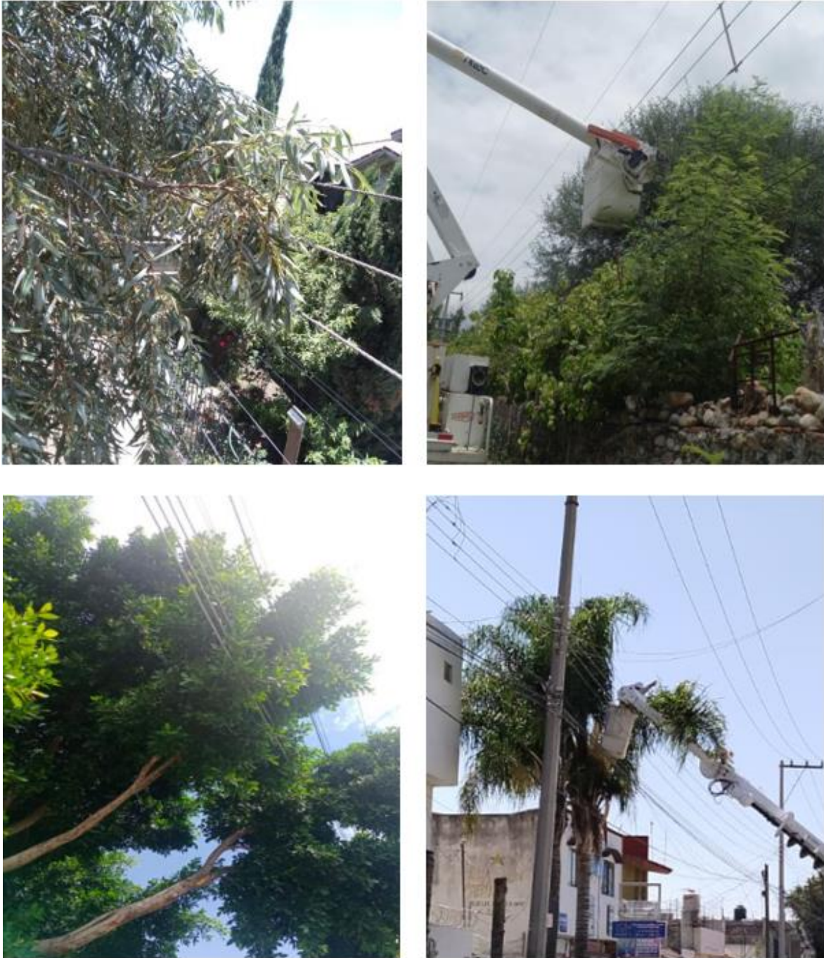
Figura 21. Mantenimiento a sector por causa de salida por árboles o ramas
