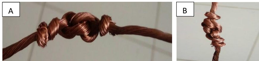
Figura 2.16. Ejemplos de empalmes tipo cazador: A) Empalme cazador horizontal. B) Empalme cazador vertical.
