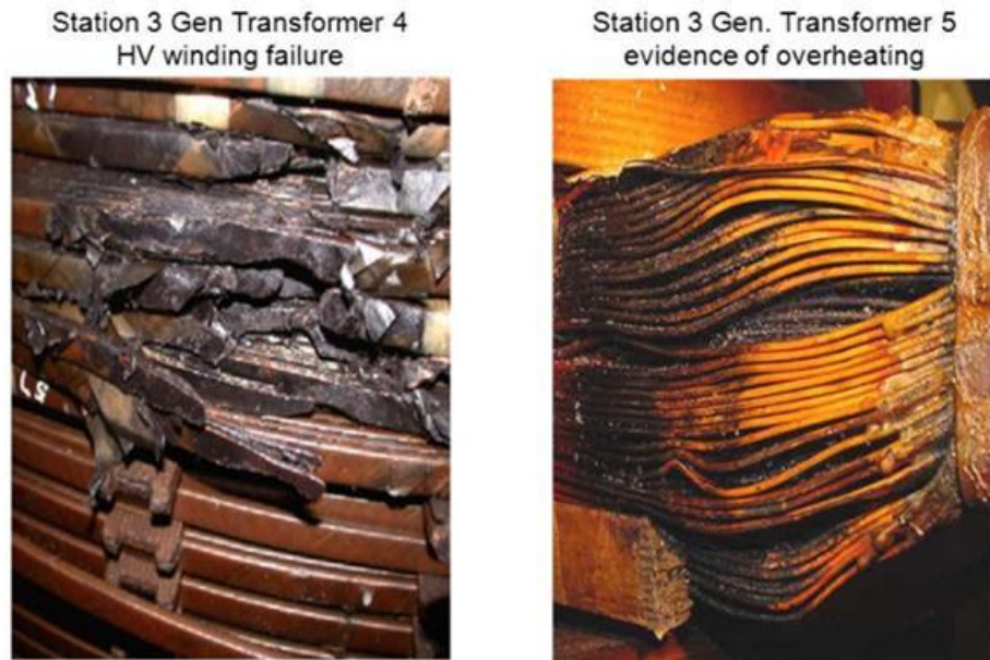
Figura 5.20 Transformadores dañados durante la tormenta "Halloween" [3]
