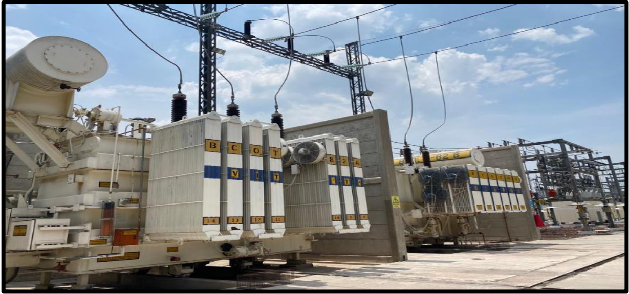
Figura No. 4.1 Transformador de potencia de 85 KV/23KV
