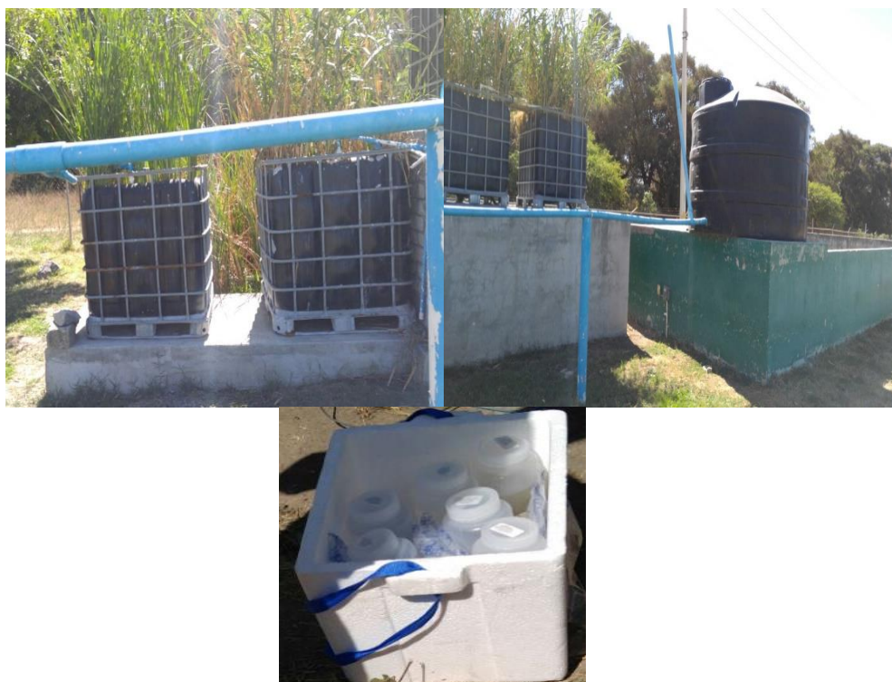
Figura 8. Humedal vertical, ubicado en la PTAR de Izúcar de Matamoros, Puebla.
