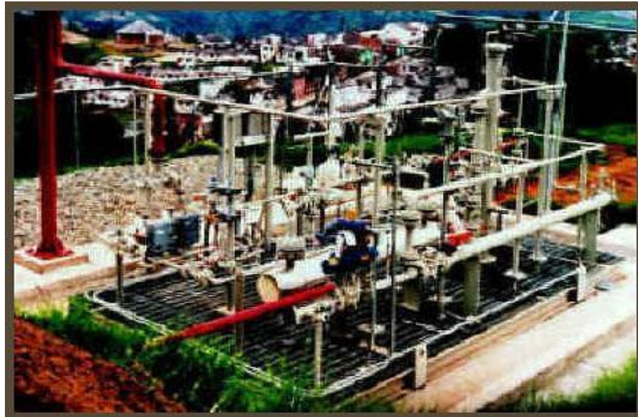
Figura 3.2 Patín de recibo y medición de gas LP (EN-FAB, in., 2014)
