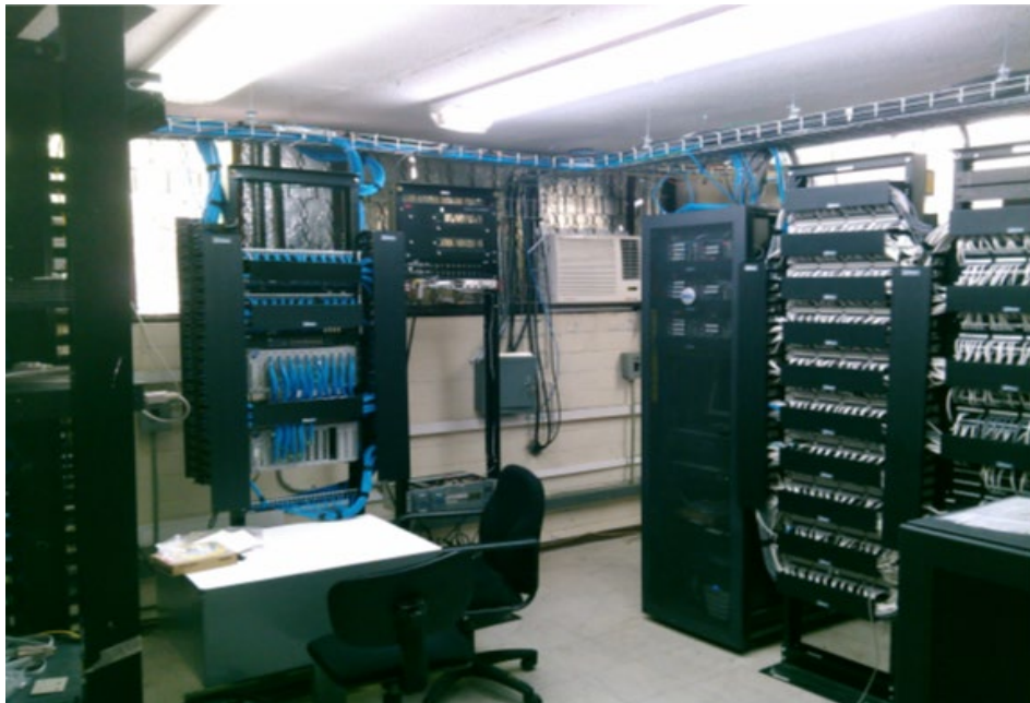
Figura 35. Centro de Datos en INAOE
