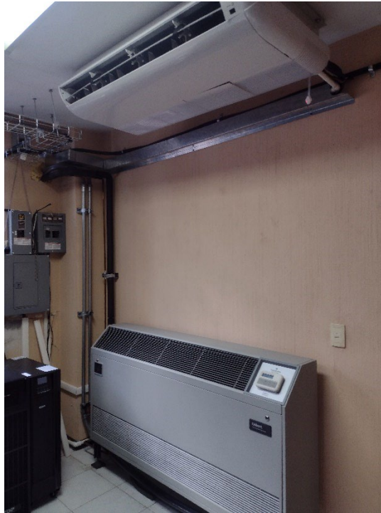
Figura 50. Sistema de aire acondicionado en Centro de Datos
