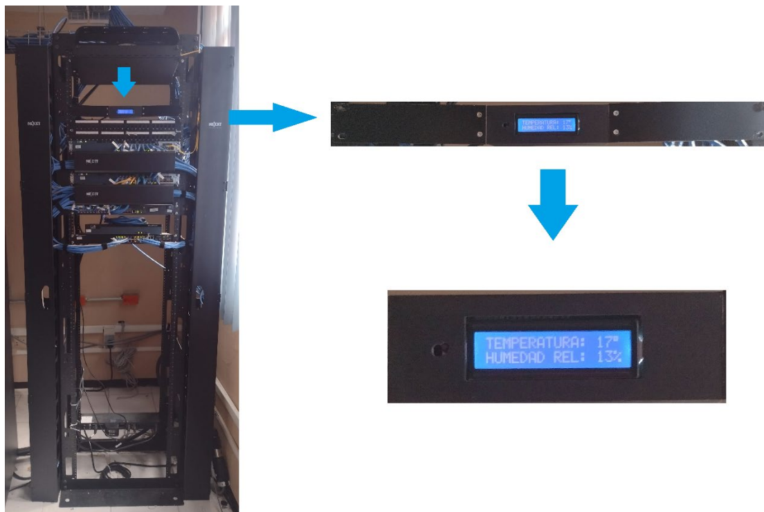
Figura 40. Sensor montado en Rack de 45U en Centro de Datos
