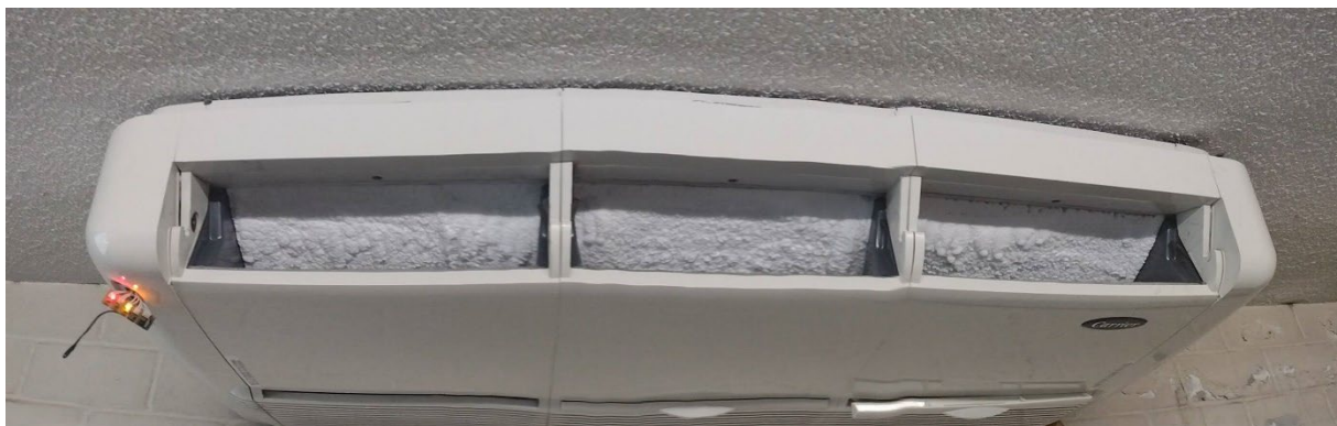
Figura 52. Evaporadora escarchada en el Centro de Datos “Micro2”
