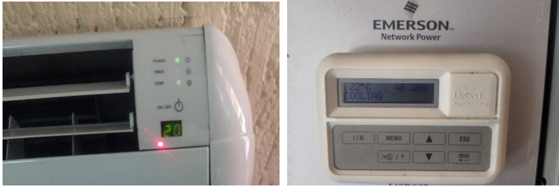
Figura 57. Sensor de temperatura embebidos en los equipos de aire acondicionado
