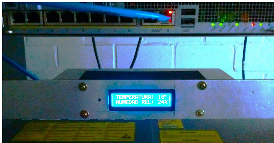
Figura 54. Primer sensor de temperatura y humedad instalado en 2016
