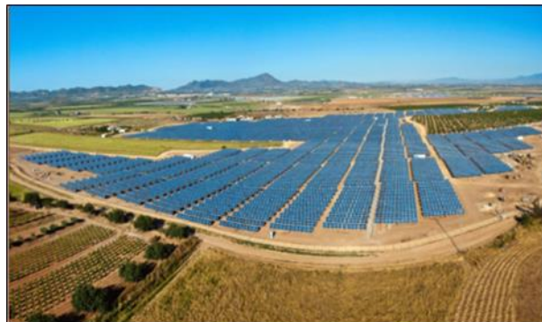
Figura 5.5 EJEMPLO DE UNA INSTALACION FOTOVOLTAICA CON EL SISTEMA DE SEGUIDORES SOLAR A 1 EJE HORIZONTAL
