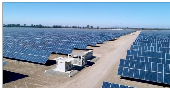
Figura 1.5 PLANTA FOTOVOLTAICA DON JOSÉ [8]
