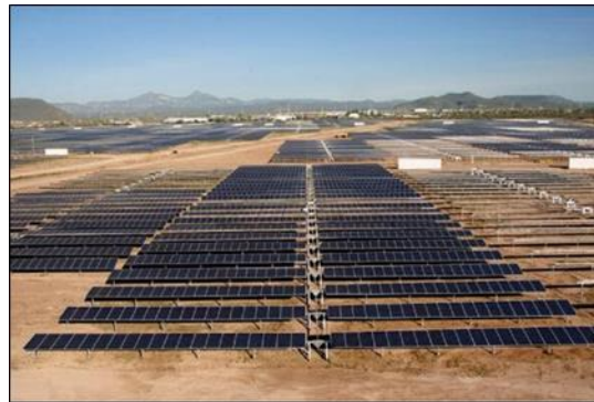
Figura 1.7 PLANTA FOTOVOLTAICA AURA SOLAR 1 [12]
