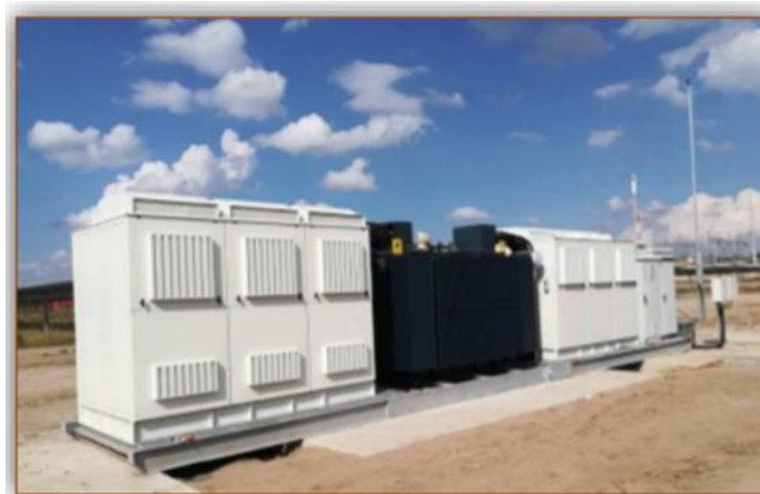
Figura 2.11 EJEMPLO DE LAS ESTACIONES DE PODER BT O CENTRO DE INVERSIÓN- TRANSFORMACIÓN [53]
