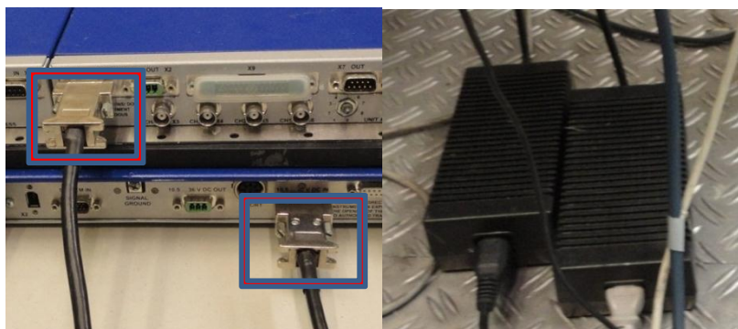
Figura 13. Entrada de alimentación con sus reguladores
