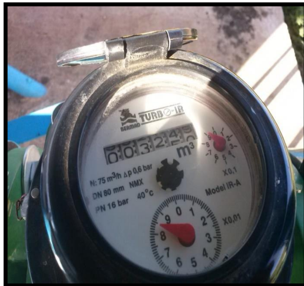
Figura 12. Medidor de agua marca TURB-IR.
